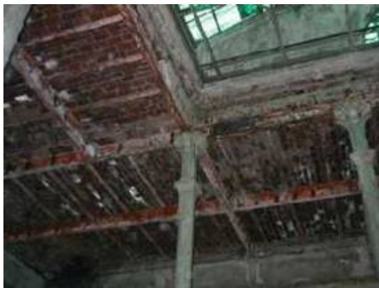
Fig. 7 – Columnas H. F. en P. Principal materiales y procedimientos no agresivos para la construcción existente y se verificaron comportamientos con pruebas de carga.
