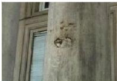
Fig.28- Columna deteriorada Fig.29_ Desplazamientos
