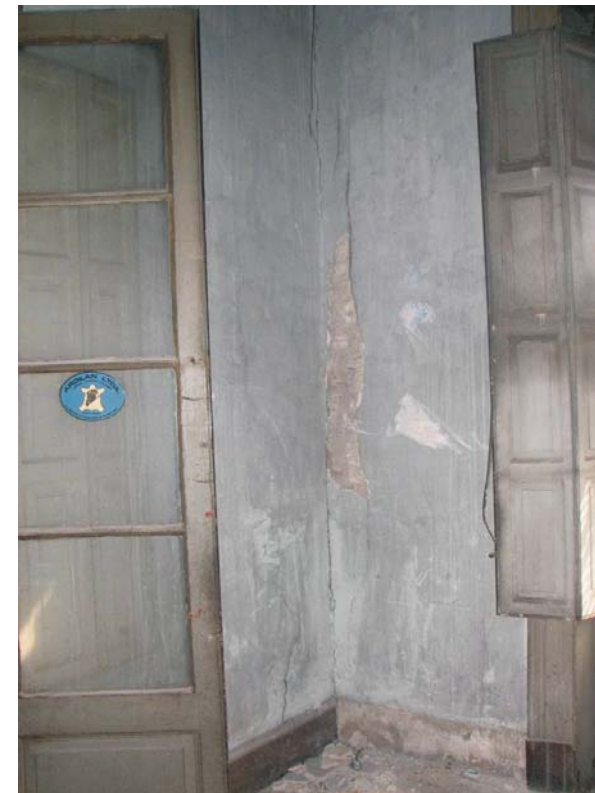
FISURA VERTICAL CONTRA FACHADA
