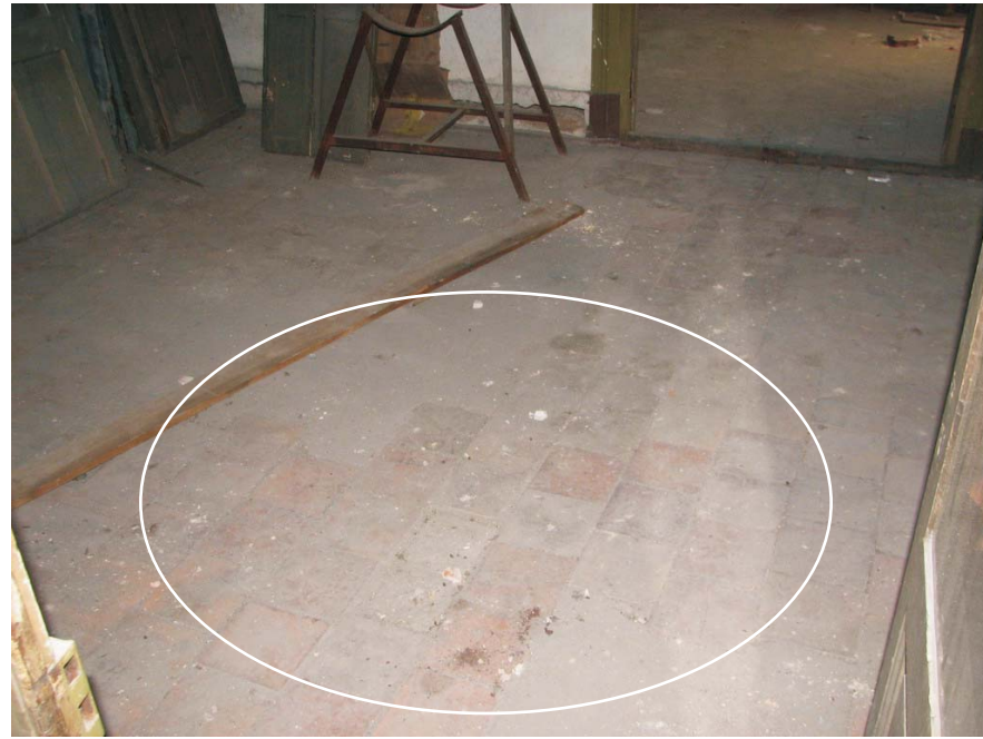
PARCHES EN PAVIMENTO DEL ENTREPISO
