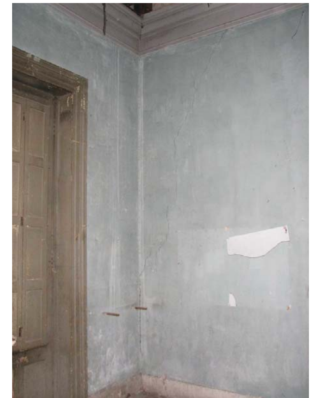
FISURA VERTICAL CONTRA FACHADA
