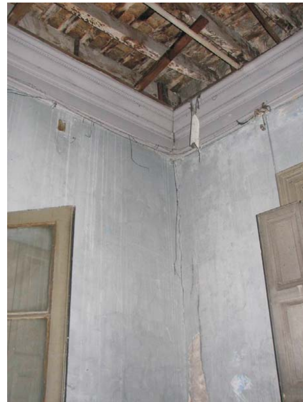
FISURA VERTICAL CONTRA FACHADA
