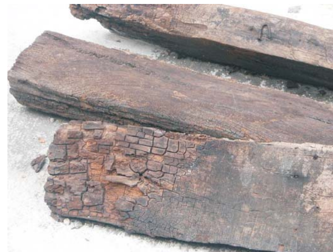
DETERIORO DE TIRANTES
