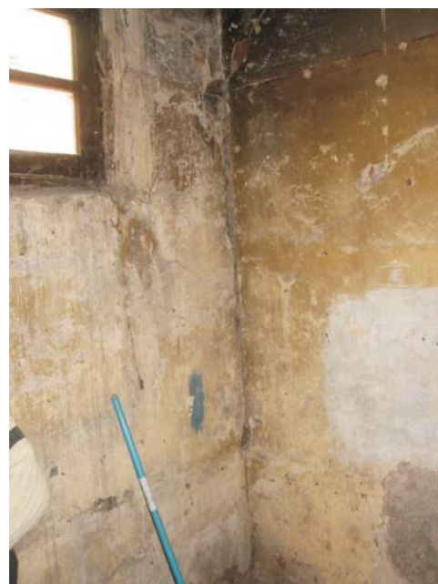
FISURA VERTICAL ENTRE MUROS
