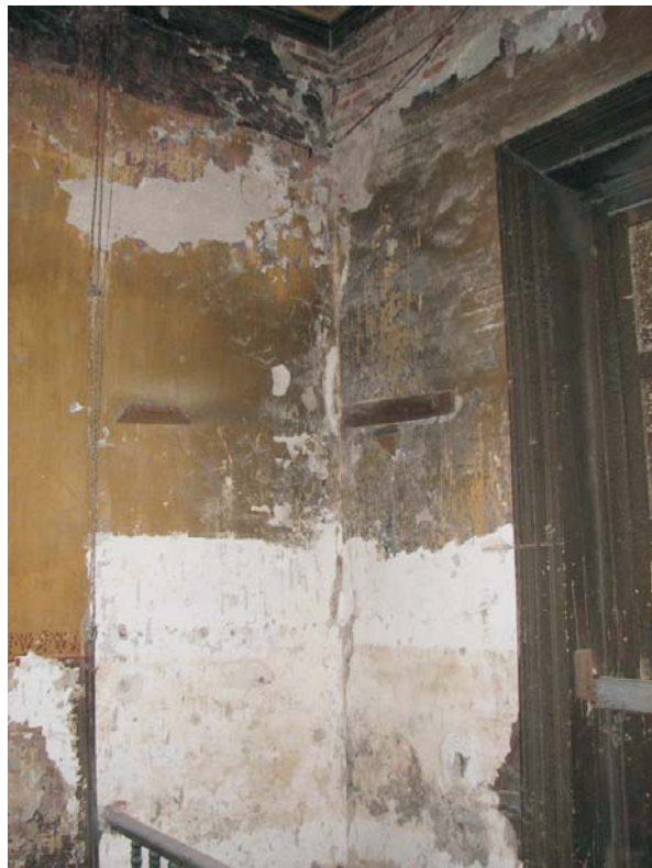
FISURA VERTICAL CONTRA FACHADA
