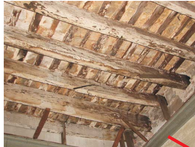
TIRANERÍA FISURADA Y ROTA
