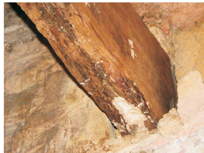
TIRANTE DETERIORADO EN EL APOYO
