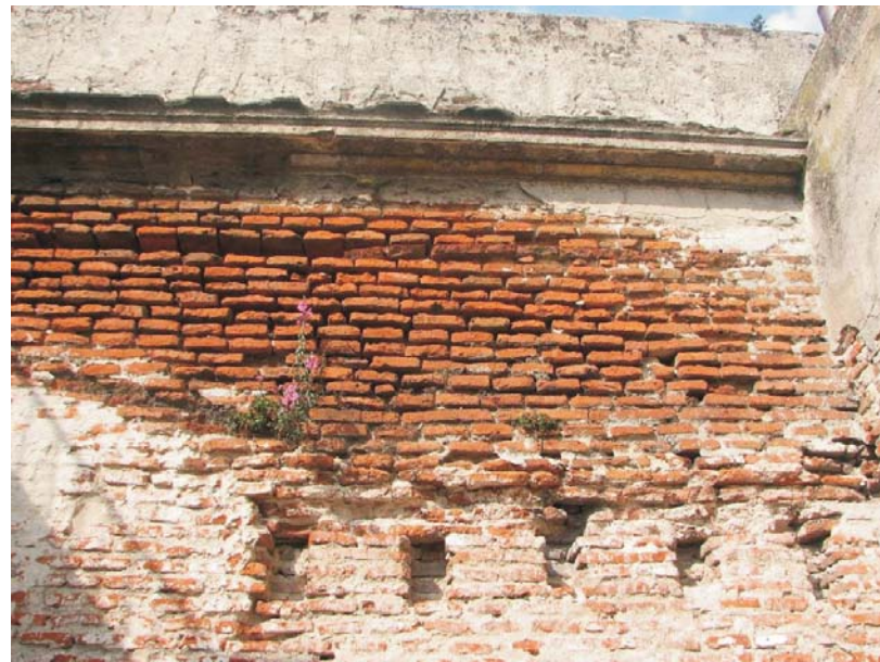
JUNTAS EXTERIORES EROSIONADAS
